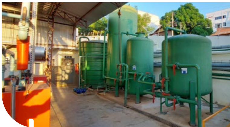
Estação de Tratamento de Efluente Industrial da Nater Coop.
